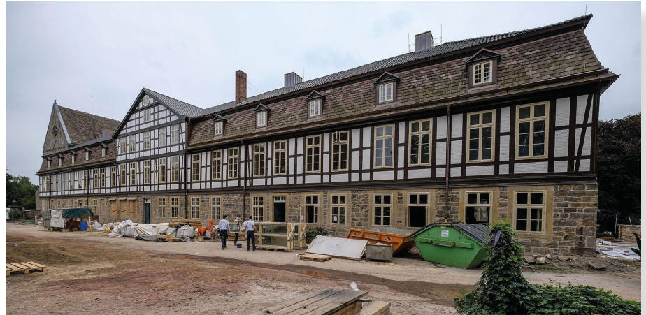
Der Umbau des Predigerseminars in Loccum verursacht erneut Mehrkosten.
